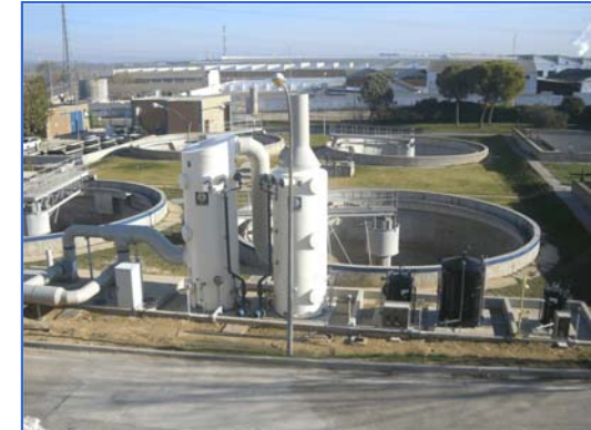
Desodorización en EDAR Urbana con 2 etapas de tratamiento químico ( H_2SO_4 / NaOCl + NaOH) para Q = 20.000 \text{ m}^3/\text{h}
