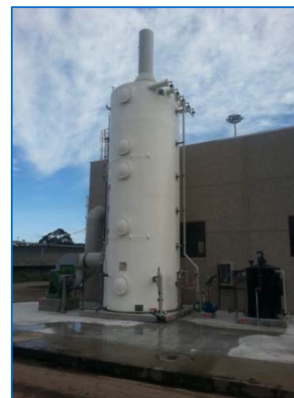
Desodorización en EDAR industrial (Q = 13.000 m 3 /h, 20 ppm de H 2 S). Aporte de agua: agua de río + nutrientes
