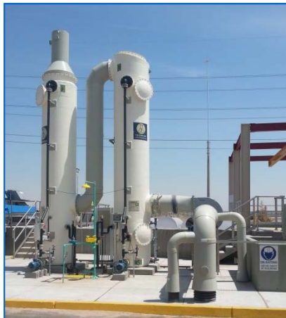
Desodorización en EDAR Urbana (México) con 2 etapas de tratamiento químico ( H_2SO_4 / NaOCl + NaOH) para Q = 30.000 \text{ m}^3/\text{h}
