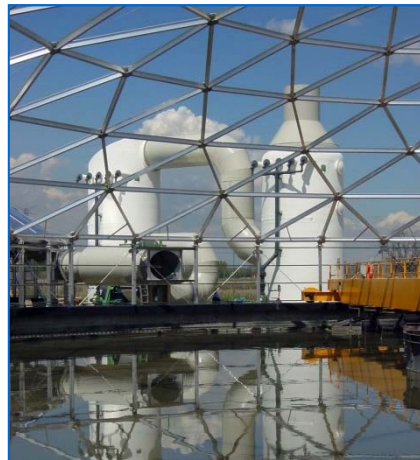
Desodorización en EDAR Urbana con 2 etapas de tratamiento químico ( H_2SO_4 / NaOCl + NaOH) para Q = 75.000 \text{ m}^3/\text{h}
