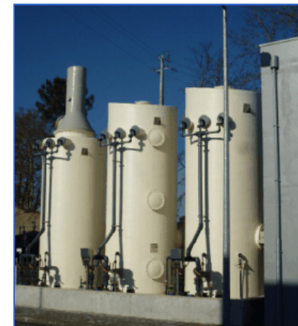
Desodorización en EDAR Urbana (Portugal) con 3 etapas de tratamiento químico ( H_2SO_4 / NaOCl + NaOH / NaOH) para Q = 15.000 \text{ m}^3/\text{h}
