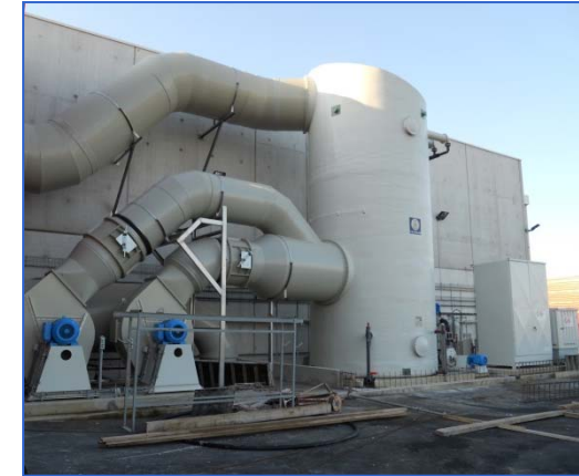
Desodorización en planta de compostaje (Francia) con etapa de prehumidificación y biofiltro orgánico para Q = 60.000 \text{ m}^3/\text{h}
