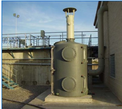
Desodorización en EDAR industrial con torre de doble lecho de carbón para Q = 5.000 \text{ m}^3/\text{h}
