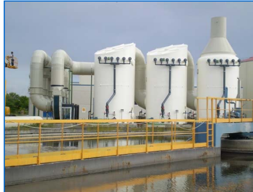
Desodorización en EDAR Urbana con 3 etapas de tratamiento químico ( H_2SO_4 / NaOCl + NaOH / NaOH) para Q = 95.000 \text{ m}^3/\text{h}
