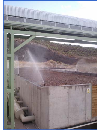
Sistema de riego en biofiltro orgánico en planta de compostaje (España) para Q = 40.000 \text{ m}^3/\text{h}
