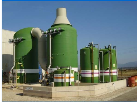
Desodorización en EDAR Urbana con 2 etapas de tratamiento químico ( H_2SO_4 / NaOCl + NaOH) para Q = 50.000 \text{ m}^3/\text{h}
