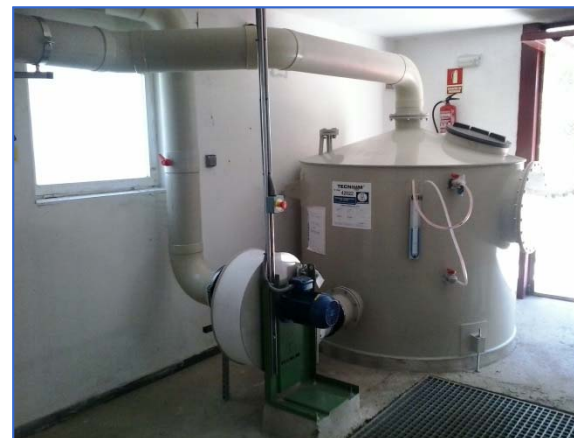
Desodorización en EDAR urbana con torre de simple lecho de carbón para Q = 2.000 \text{ m}^3/\text{h}
