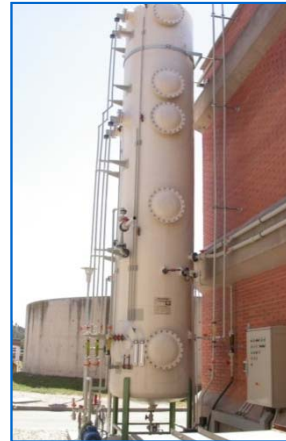
Desulfuración de biogás en EDAR urbana (Q = 100 m 3 /h, 2.500 ppm de H 2 S)
