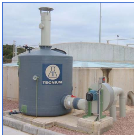
Desodorización en EDAR urbana con torre de simple lecho de carbón para Q = 3.000 \text{ m}^3/\text{h}
