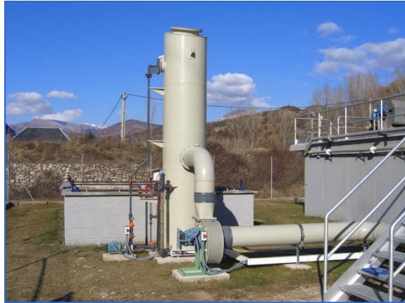
Desodorización en EDAR urbana con etapa de prehumidificación y biofiltro orgánico (España) para Q = 10.000 \text{ m}^3/\text{h}
